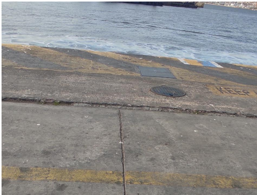
Εικόνα 2. Υφιστάμενη κατάσταση ανισοσταθμίας μεταξύ προβλήτα και οδοστρωμάτων
