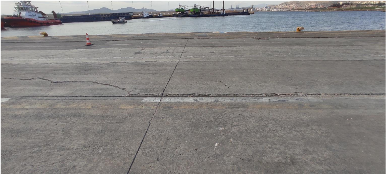
Εικόνα 1. Υφιστάμενη κατάσταση δαπέδων
