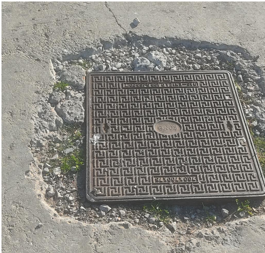
Εικόνα 4. Φθαρμένο φρεάτιο προς επισκευή
