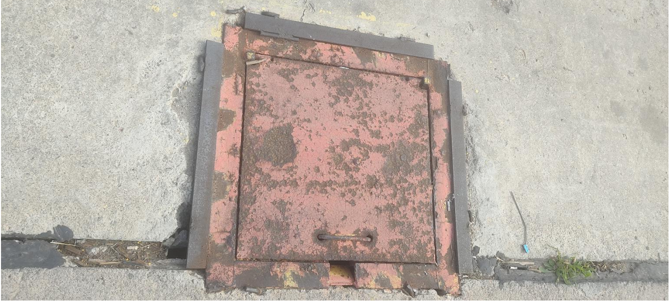
Εικόνα 3. Φθαρμένο κάλυμμα φρεατίου
